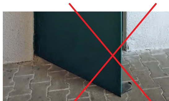
Verkeilen der Tür setzt die Schutzfunktion außer Kraft.
